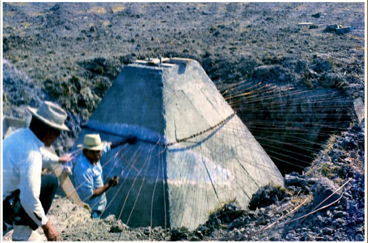
Fig. 28. Instalación de los cimientos de la estación de transmisión de Radio Educación en los predios de Iztapalapa, Ciudad de México, años setenta. Acervo de Ignacio Espinosa.
